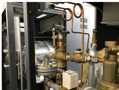
図7 オートクレーブ高圧水蒸気配管
